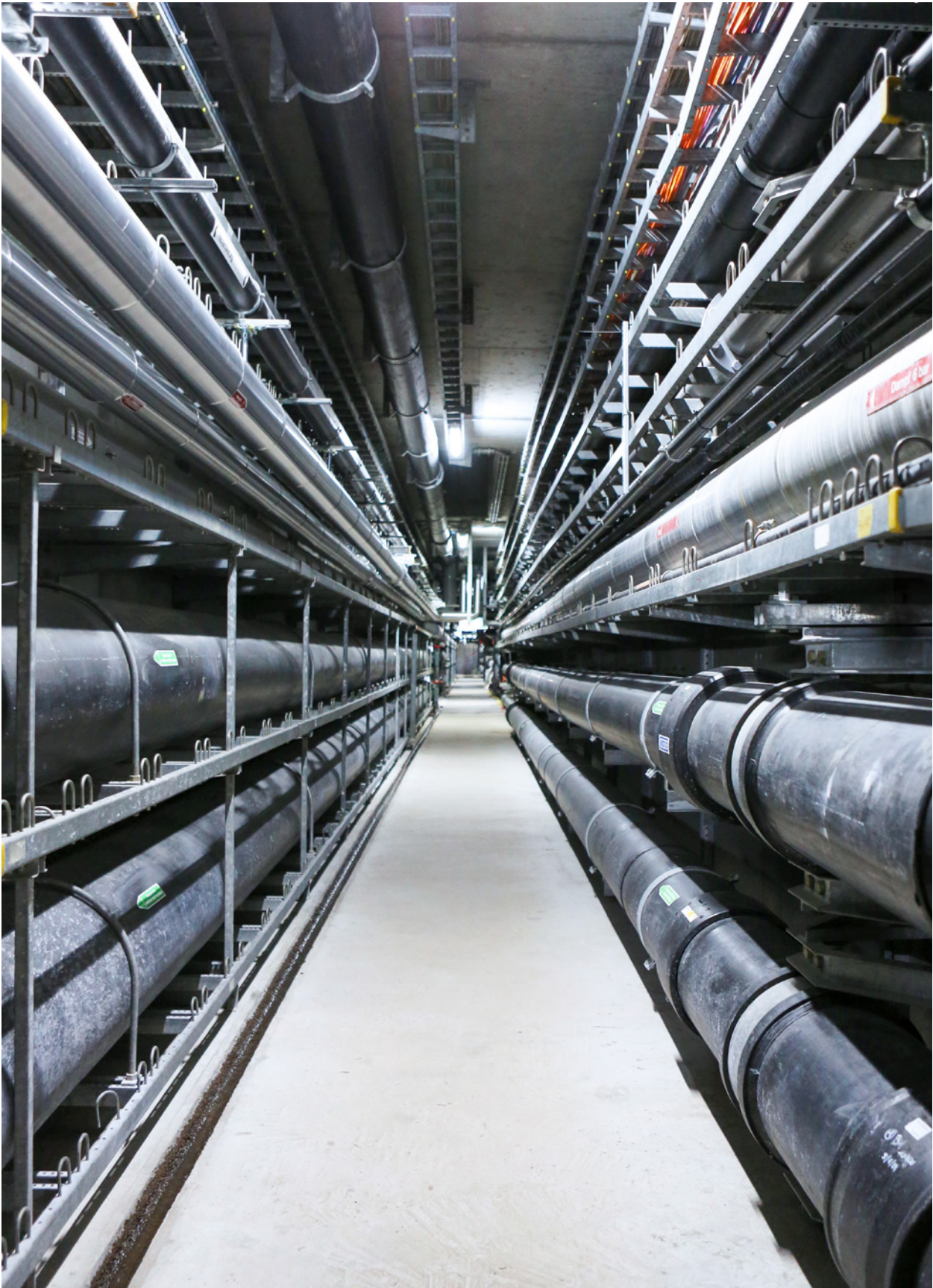
Die neu installierten grossen Transferleitungen ermöglichen einen sicheren und effizienten Transport des industriellen Abwassers von der ARA Chemie zur ARA Basel.
