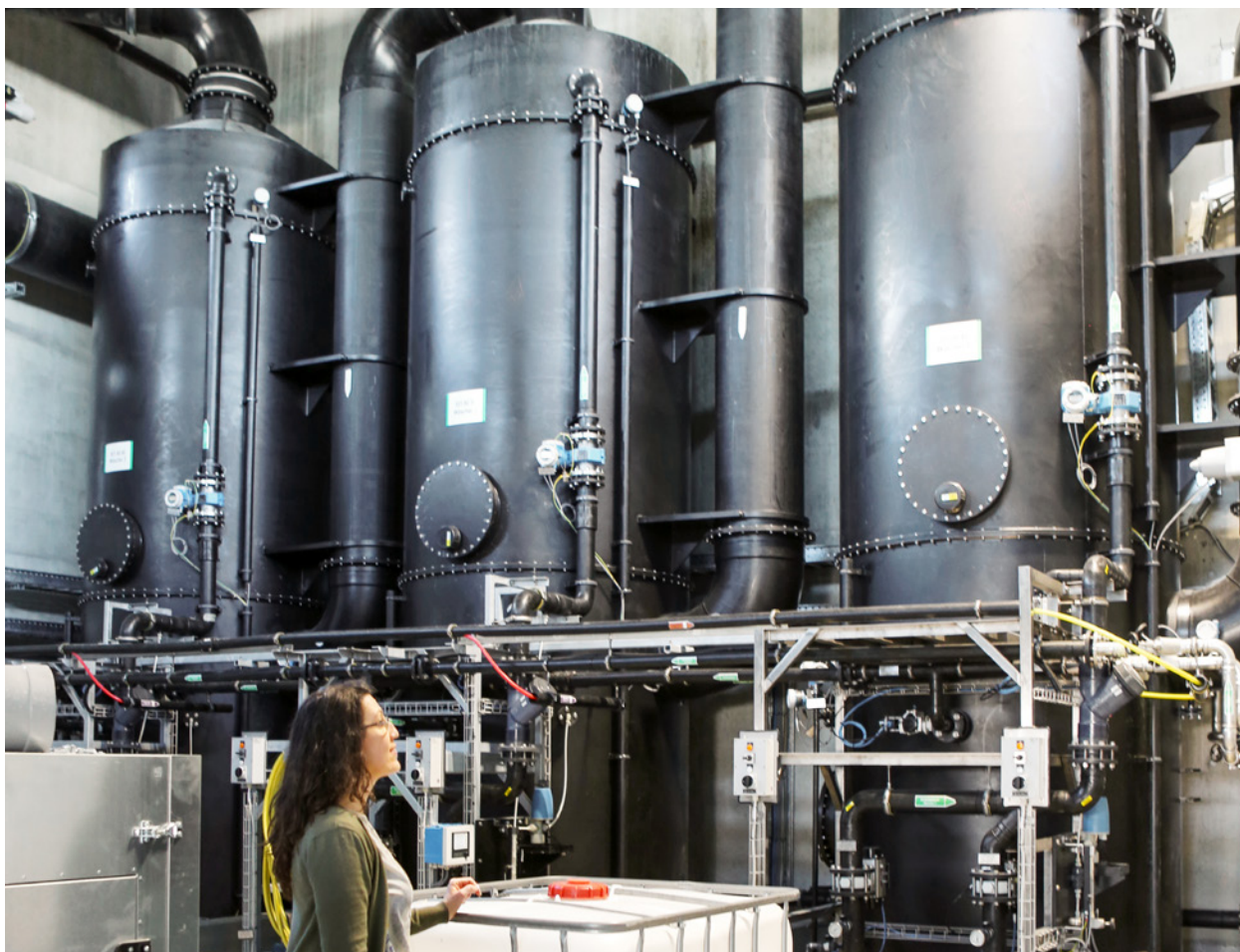
Die Abluftreinigungsanlage der ARA Basel befreit die belastete Abluft durch moderne Filter- und Reinigungstechnologien von Geruchs- und Schadstoffen.
