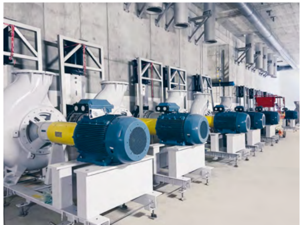
Die Pumpen befinden sich jetzt im Pumpenraum des Kopfbaus. Sie pumpen später das Schmutzwasser in die biologische Reinigungsstufe.
